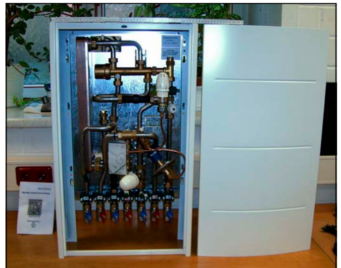
Diese handliche Übergabestation ist in den nächsten Wochen bei elektrotech Künne zur Ansicht ausgestellt
